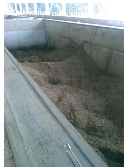
Фото 2. Топливный склад котла
